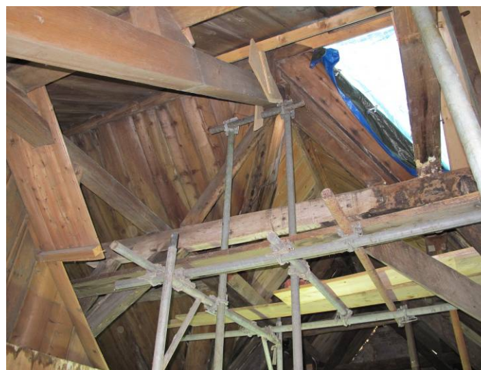
Complexe constructie bij overgang dwarskap op langskap.
