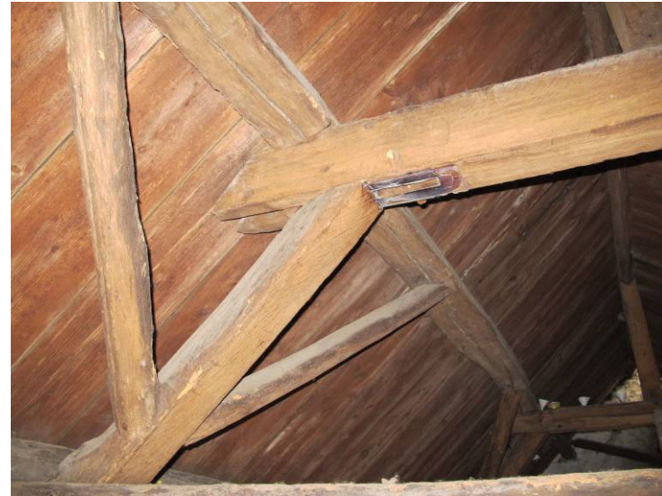
Aan weerszijden van het spantbeen zijn gaten zichtbaar van een eerdere aansluiting voor een bredere kapopzet.
