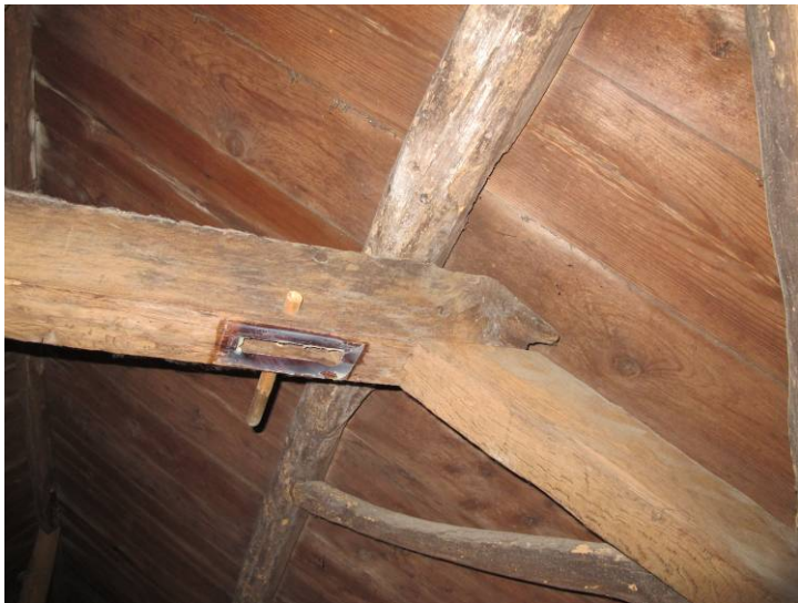
Telmerken zijn op géén van de onderdelen aangetroffen.
