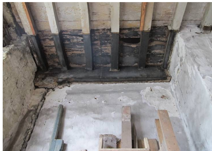
Verticale scheur bij aansluiting voorgevel (I) op linker zijgevel.
