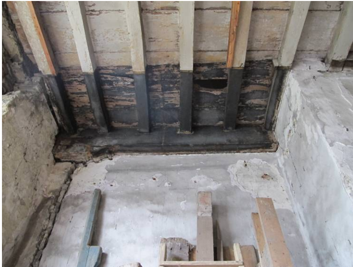
Afwijkende kleurstelling op strook van balklaag naast de schouw.
