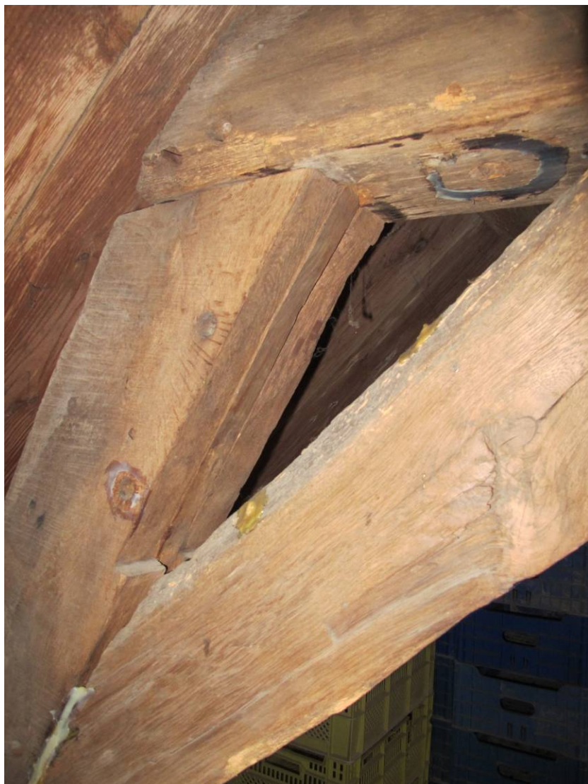
Diverse sporen van aanpassingen bij de aansluiting van het spantbeen op de dekbalk.
